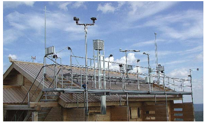
Kuva 2. Puijon tornin katolle on tarkoitus asentaa vastaavanlainen mittauslaitteistopatteristo kuin Pallastunturilla.
